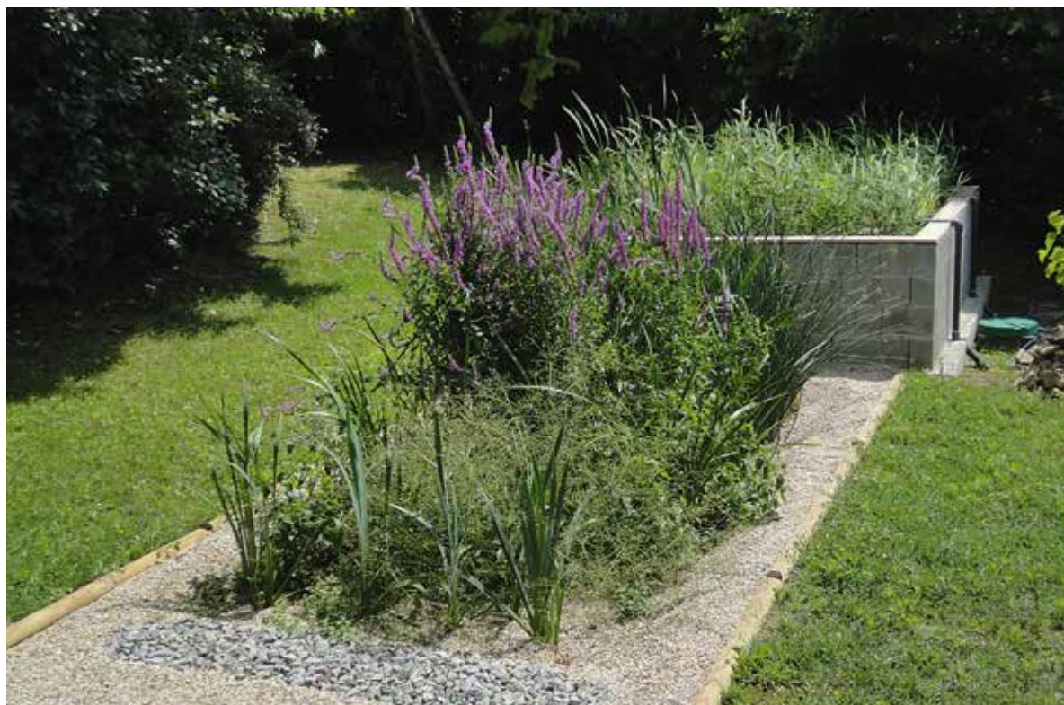
Filtres plantés, un assainissement non collectif naturel
